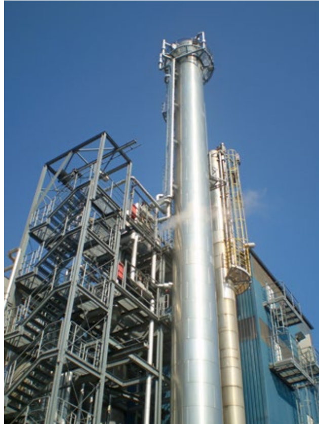
In Spalttürmen wird die Glycerinphase von der Fettsäurephase getrennt.
